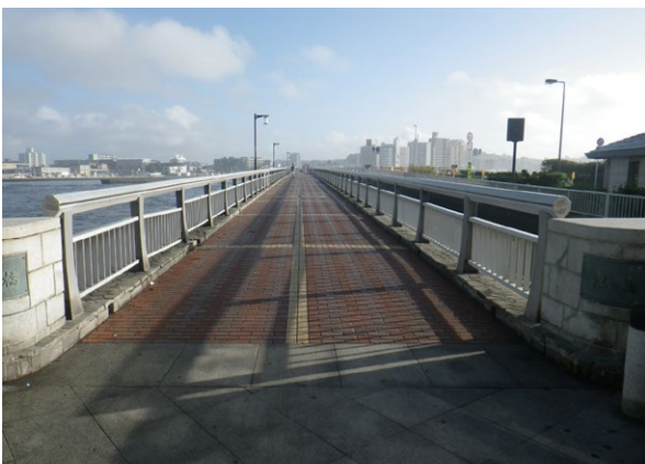
老朽化の進んでいた江の島弁天橋
