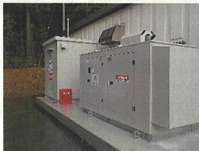
取水ポンプ所
