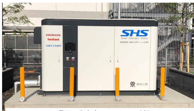
県再エネ水素ステーション外観
