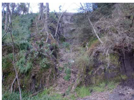
写真② 斜面の崩落跡
