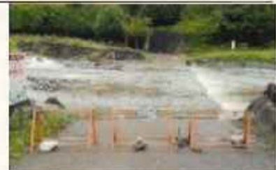
「沢の橋」の通行止め措置
