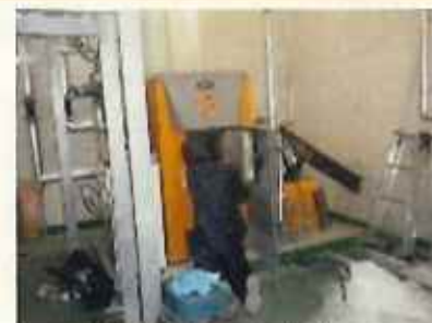
バイオマスボイラーの点検
