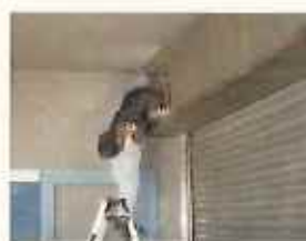
シャッター定期点検
