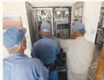
電気設備保守点検
