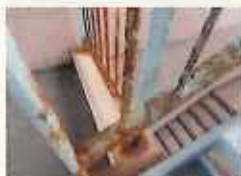
塩害による錆
