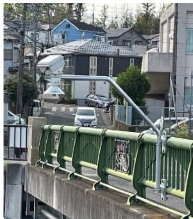
危機管理型水位計設置状況 (引地川 福寿橋)
