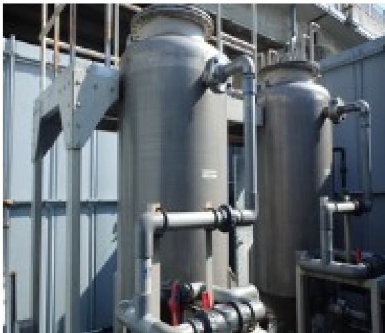
地下水汚染対策（秦野市 浄化施設）
