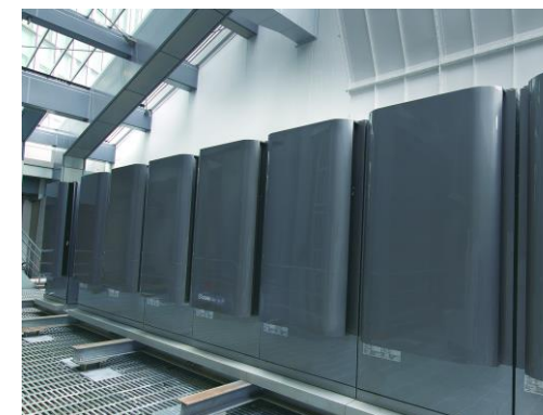
(横浜市燃料電池システム)
