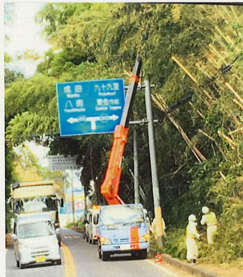
倒木が電力設備に覆い被さった現場
