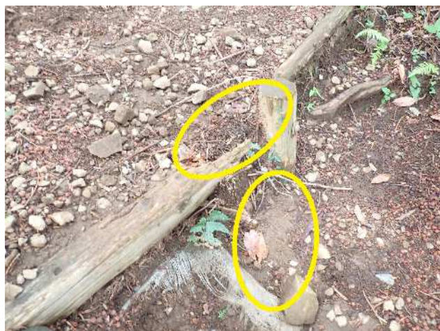
上の囲み：開いた穴、下の囲み：水の流れた跡
