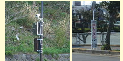
団体管理の防犯カメラと設置表示看板
