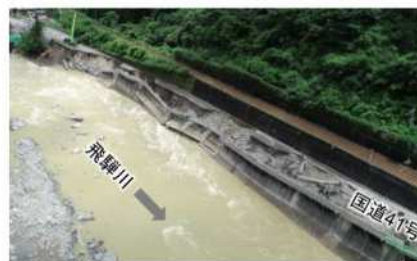
国道41号 道路崩壊 (岐阜県下呂市)
