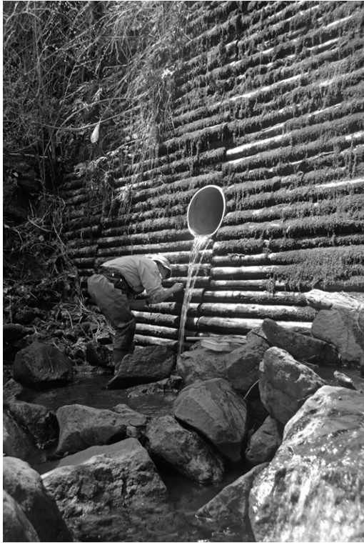
写真2 クラミ沢治山堰（林道橋上）
