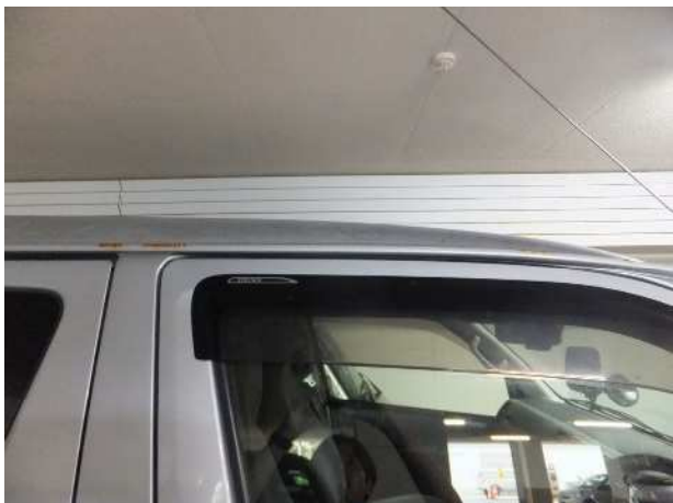
天井付近のサビ・汚れ①
