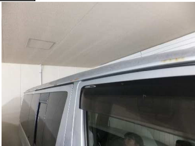
天井付近のサビ・汚れ②
