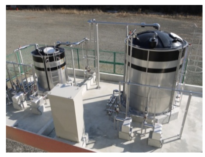
凝集剤添加設備
