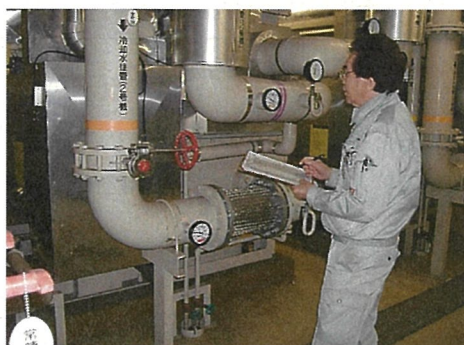
設備日常点検
