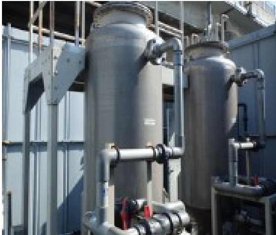
地下水汚染対策（秦野市 浄化施設）
