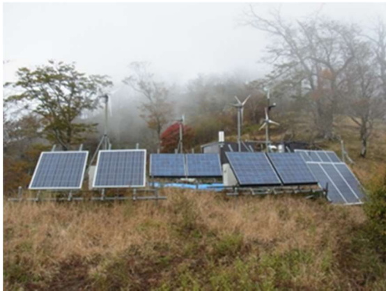
(写真) 気象観測施設 (檜洞丸)
