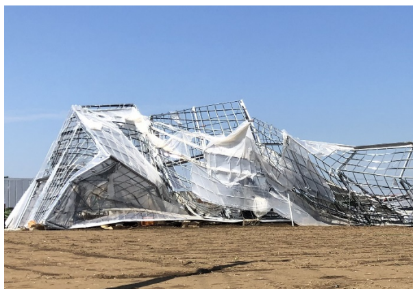
【破損した農業用ハウス（三浦市）】
