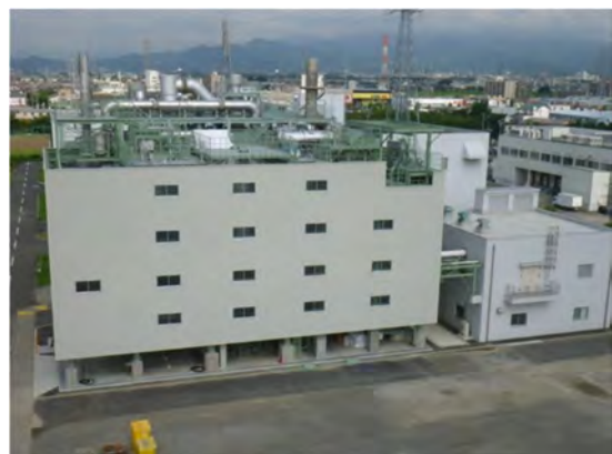
北系2号汚泥焼却設備 全景
