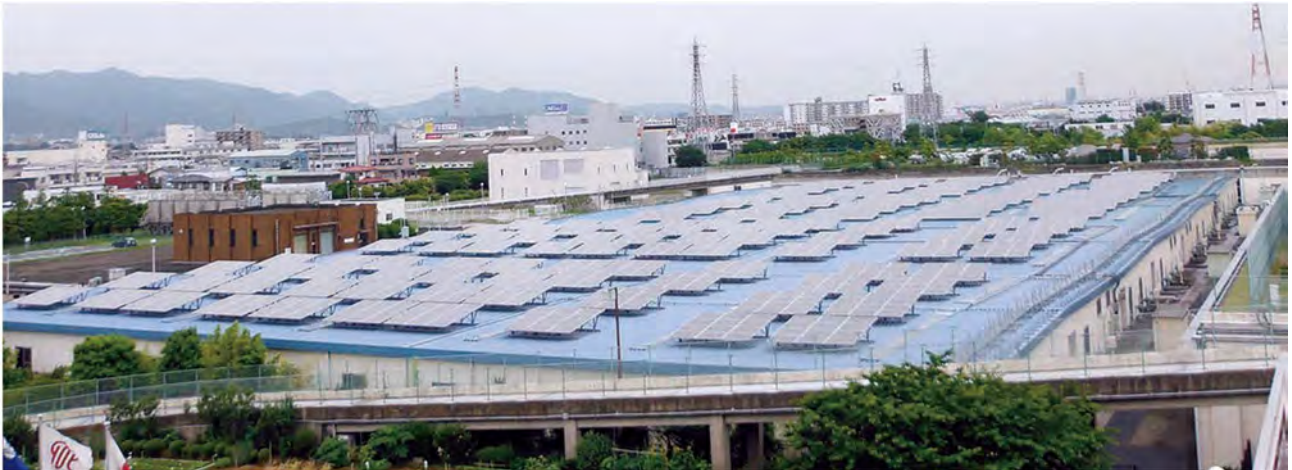
太陽光発電設備
