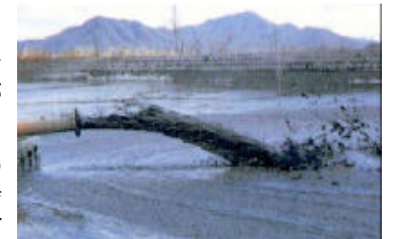
写真一パイプの吐出し口
