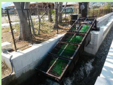
開成町小水力発電設備
