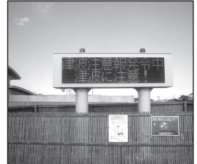
津波警報や注意報が発表された場合に、自動的に回転灯が点灯し、電光掲示板に情報が表示される「津波情報盤」
