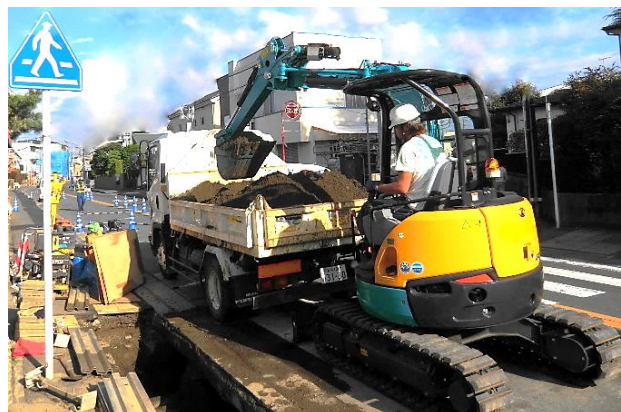
【水道管埋設状況】
