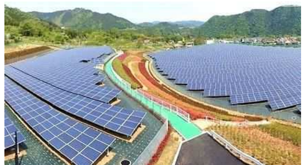
【愛川太陽光発電所】
