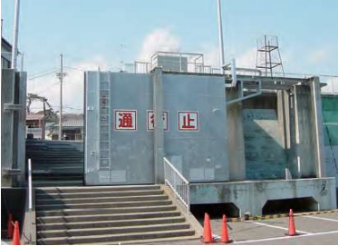
電動化した陸閘(大機港海岸)
