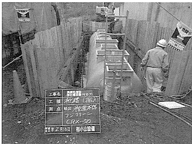
有料老人ホームの高度処理型浄化槽(50人槽)をクレーンで所定の位置に据付ける。
