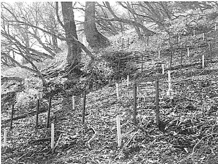
写真 金網筋工（茶色の網の中及び上部に落枝落葉を貯留させて土壌流出防止効果を発揮する施設）施工箇所に設置した土砂移動量調査枠（白色鋼製柱が枠状に設置されている）
