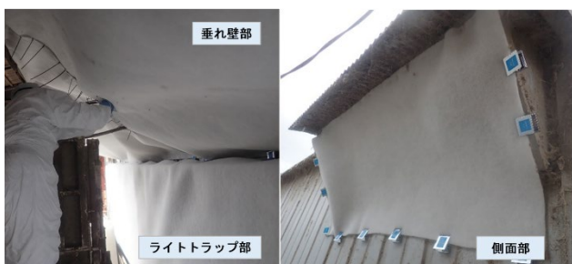
写真1 フィルター設置後
