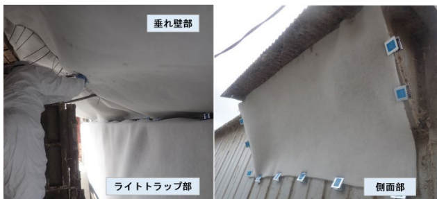
写真1 フィルター設置後
