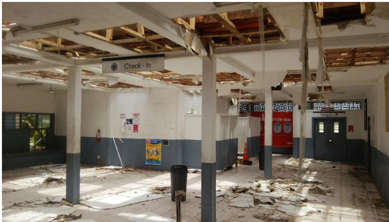
チェックインカウンター付近は屋根が飛ばされ、天井が抜けて、無残な姿です。
