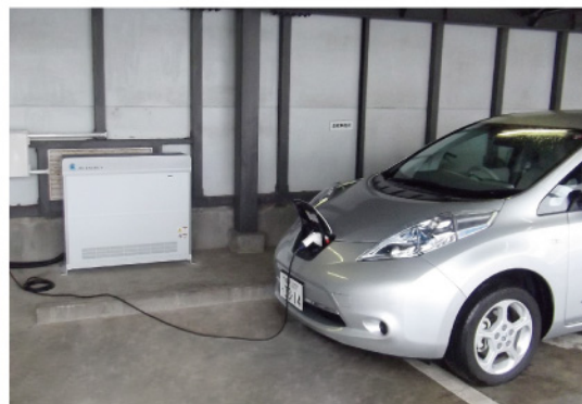
よこすかみづ けんせいそうごう (横浜賀三浦地域県政総合センターに設置した蓄電システム)
