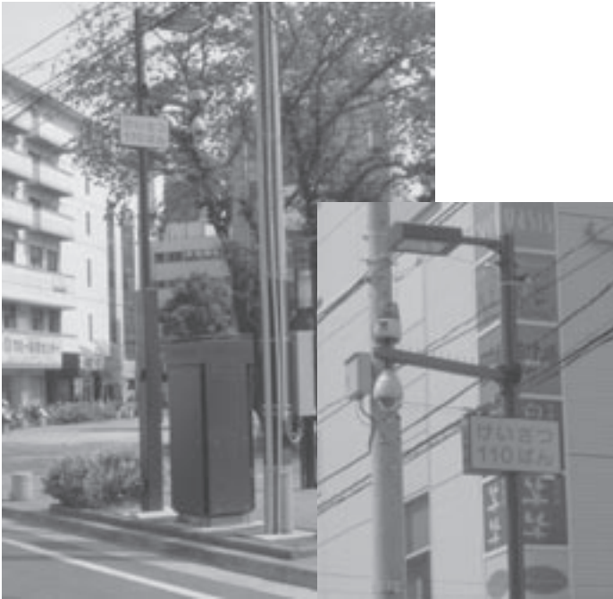
⑩スーパー防犯灯設置整備（本厚木駅前）
