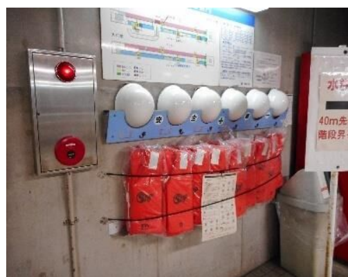
緊急用救命胴衣・ヘルメットの設置
