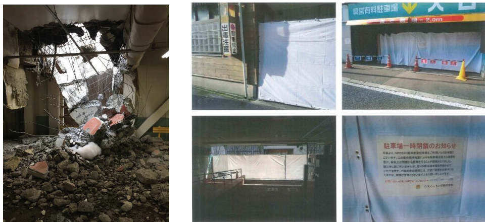
崩落箇所もあり、危険と判断し、駐車場を閉鎖しました
