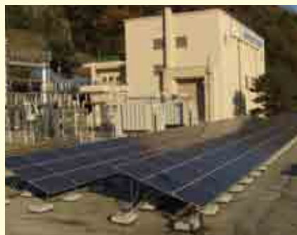
太陽光発電設備(津久井発電所)
