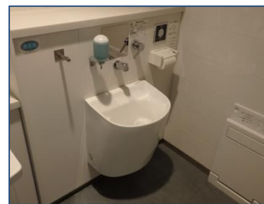
▲オストメイト対応設備
