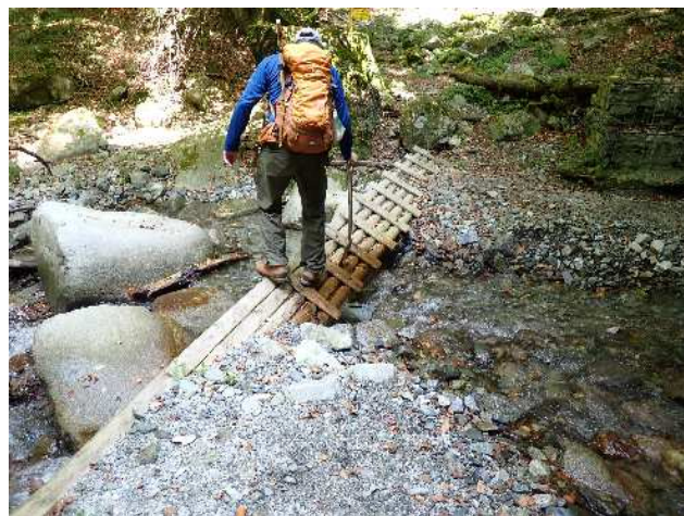
水流で木橋が傾いていました
