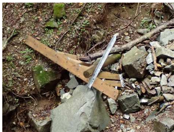
現在の壊れた階段工
