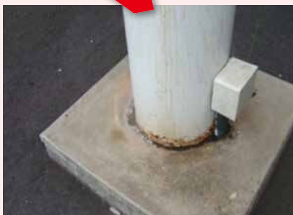
ポールの根元にサビが発生
