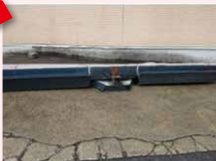
落下した欄間看板
