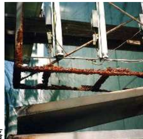
袖看板の底部脱落
