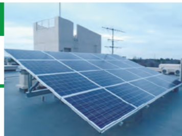
県立弥栄高校に設置した太陽光発電設備
