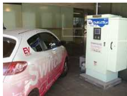
図1.1.7 神奈川県庁前に設置された急速充電設備
