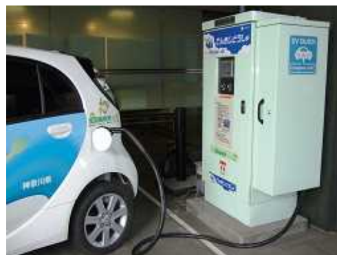
図3.2.1 神奈川県庁前に設置された急速充電設備
