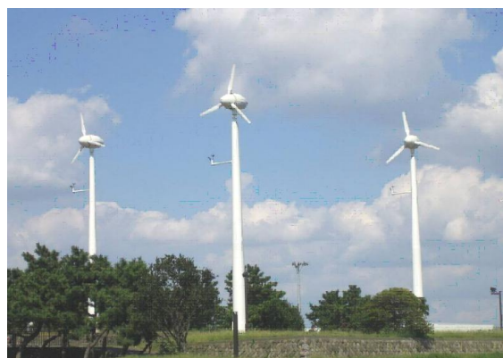
図 1.1.4 風力発電設置例（川崎市浮島町公園）
