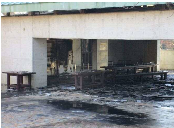
火災後の状況（風のテラス）
