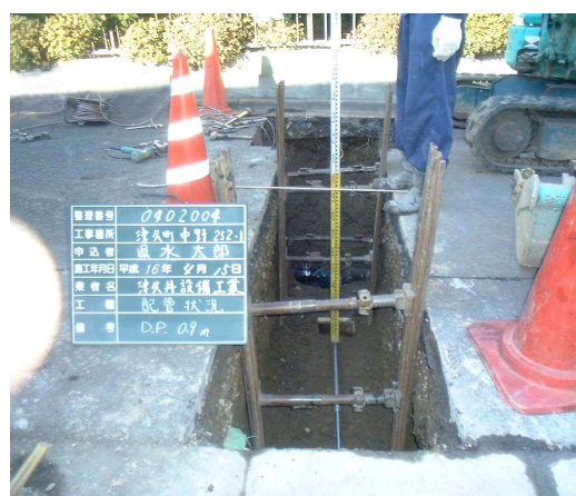
⑥ 配管状況
