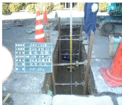
⑥ 配管状況
